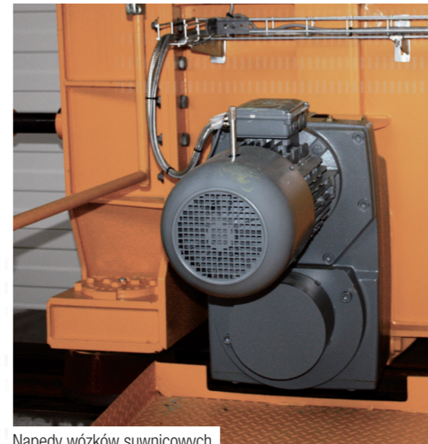
Napędy wózków suwnicowych
