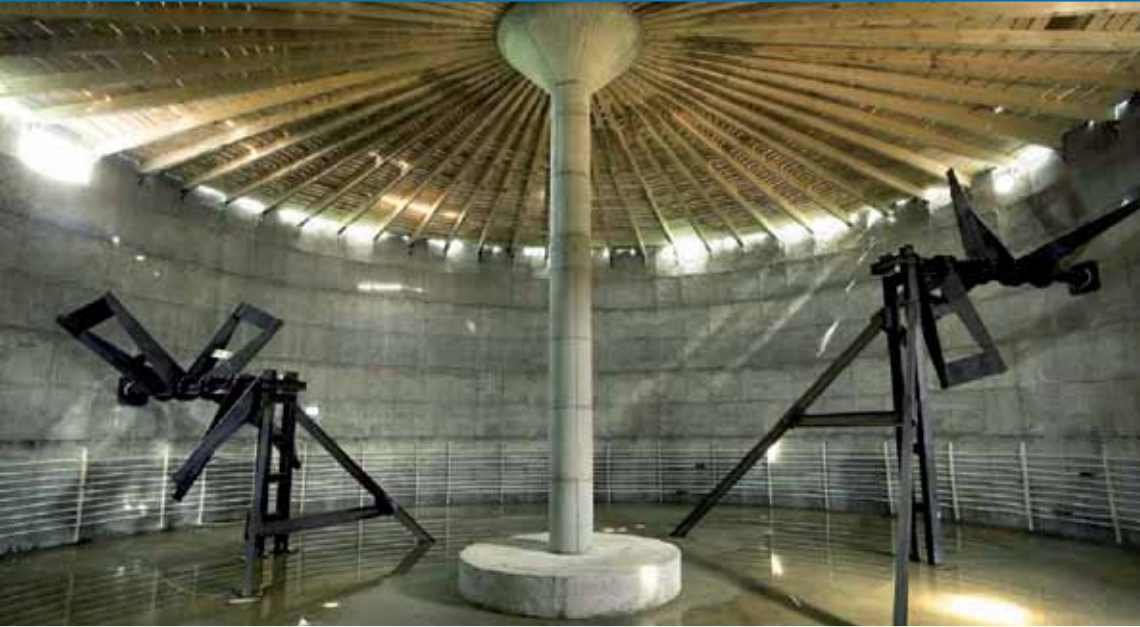
Grubenspeicher-Fermenter mit Großflügelrührwerk
