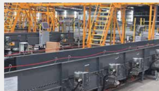
BCS-Lösung für die Toll IPEC-Anlage in Melbourne
