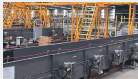
Soluzione BCS per l'impianto Toll IPEC di Melbourne
