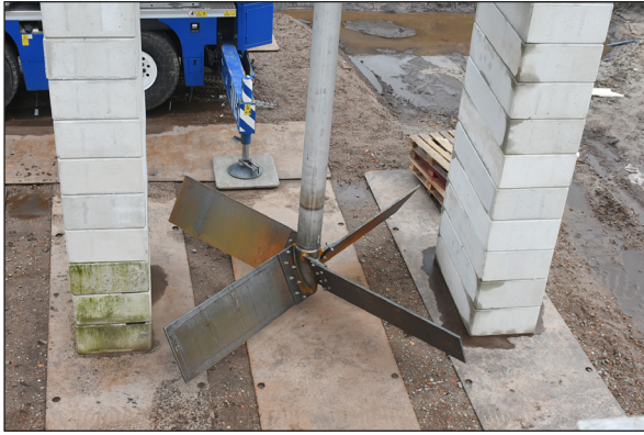
Boven: De propellers van het roerwerk.
