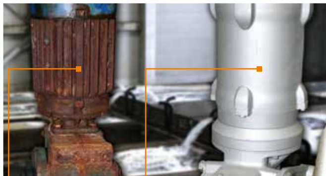
Motoredutor pintado após 12 meses de funcionamento
